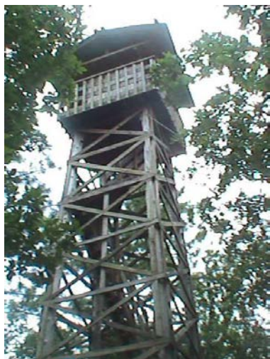
Fotografía No. 1 Torre de control de incendios ubicada en el sector del Guachipilín Montecristo
