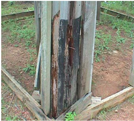
Fotografía No 2 Estructura de protección en mal estado por agentes bióticos y abióticos
